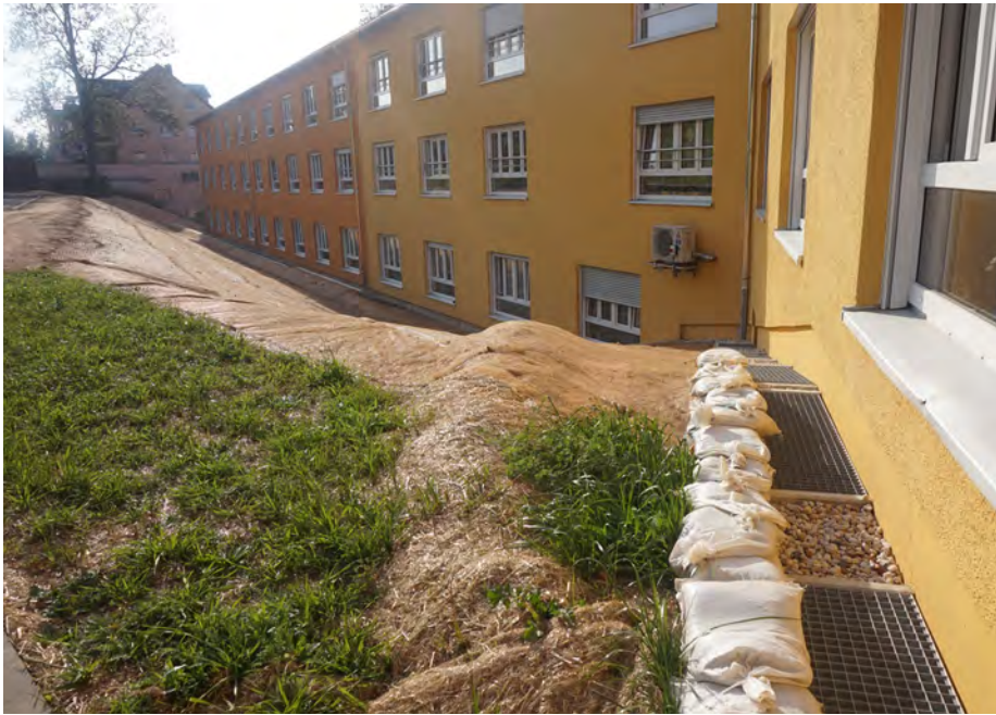
Schadensfall durch von Nachbargrundstück zuströmendes Wasser und unzureichende Ausbildung des Fassadenanschlusses.
